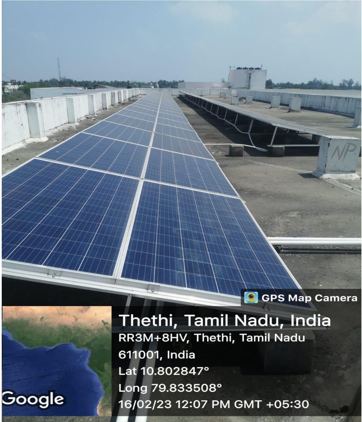
Solar PV plant (SJ Block)
